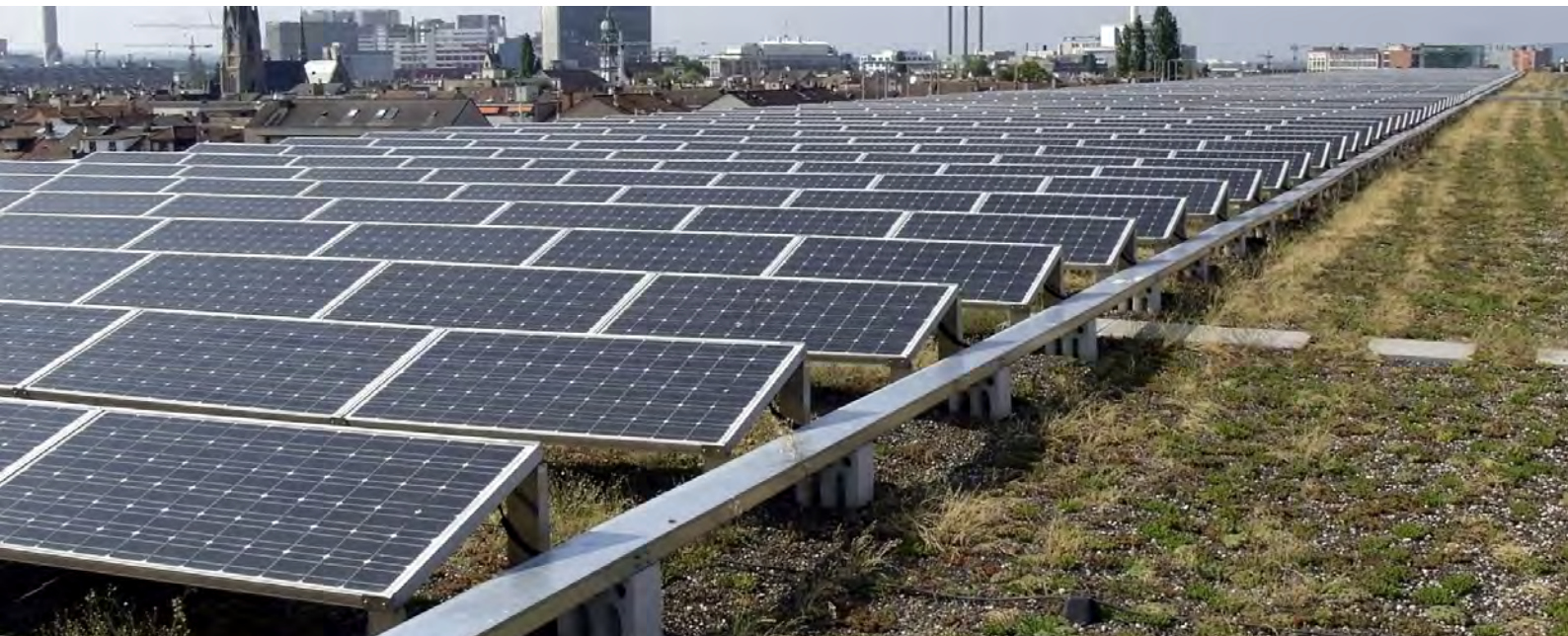
Photovoltaik-Anlage auf dem Dach der Messe Basel
